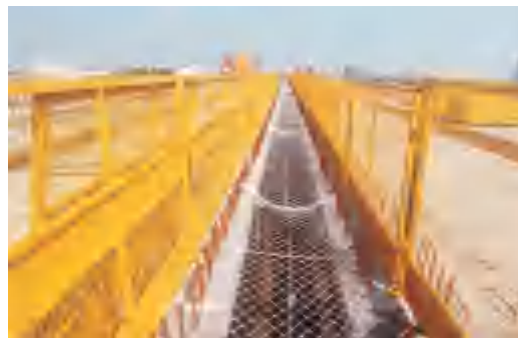
桥梁临边防护
