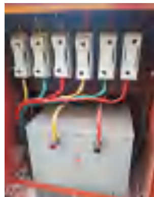
低压供电设备
