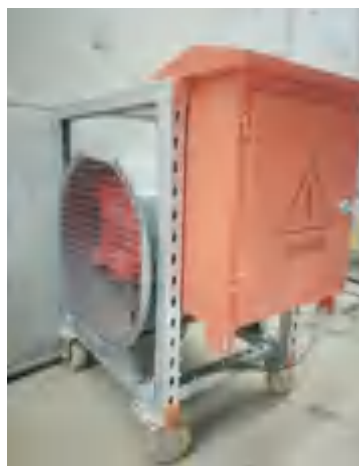
通风换气设施
