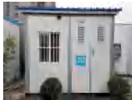
集成式总配电室
