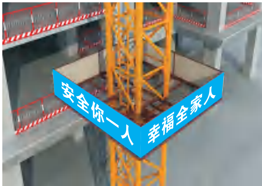
塔吊防攀爬装置
