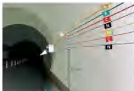
隧道内电力线路
