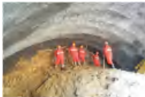
预留核心土环形开挖
